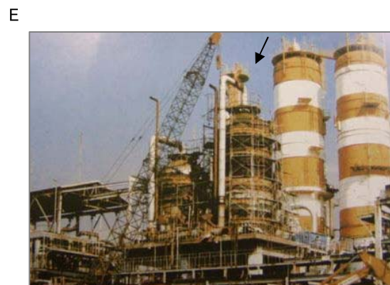
E 石油精製工場のプラント老朽化による解体工事。手順としては、石綿断熱材などの有害物質が飛散しないように、シートで覆った空間の中で撤去してから、重機で解体します。
