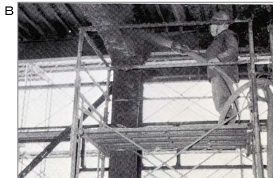
B 鉄骨建て方・床・屋根が出来ると耐火工事が始まります。吹きつけ機を用いて石綿の吹きつけをおこなっていました。
