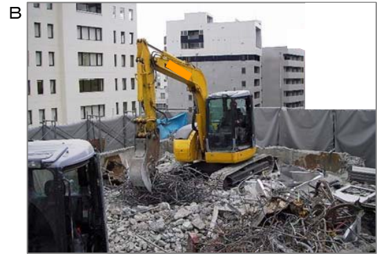
B 屋上に重機を乗せてからのビル解体作業。解体建物の外周部にはその階より高くシートを張ります。建材に石綿が含有している場合には、建材の破碎により現場の作業員が石綿粉じんにはく露する可能性があります。
