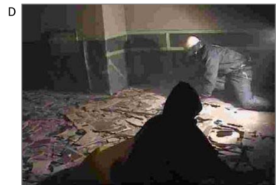
D 天井の石綿セメント板(フレキシブル板)をパールで破壊し、かき集めているところ。破碎に伴い、粉じんが舞っています。
