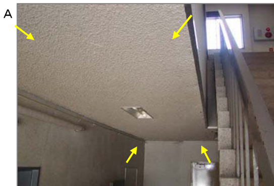
A 階段やホールの天井に吹きつけられたパーミキュライト・パーライト吹きつけ。これらにも石棉含有の時期があり飛散性石棉の分類に入っており、作業者がばく露した可能性があります。
