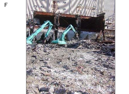
F 多量の石綿製品が使われていた工場などの解体で、重機を使用するのは石綿ばく露の面から大変危険です。保温材が重機で押しつぶされて雪のように白くなって散乱しています。
