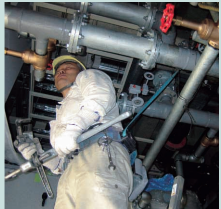
空調機械室内配管
