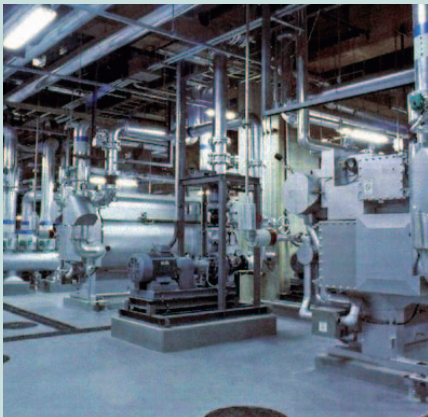
中央機械室配管
