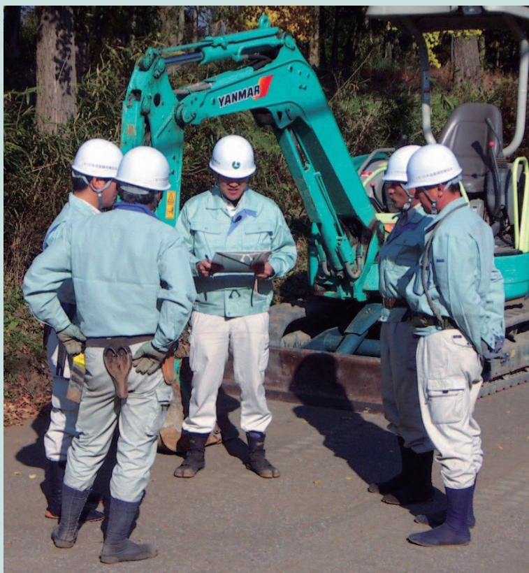
工事前の打合せ（各工種の担当者に技能面からの指示を与えます）
