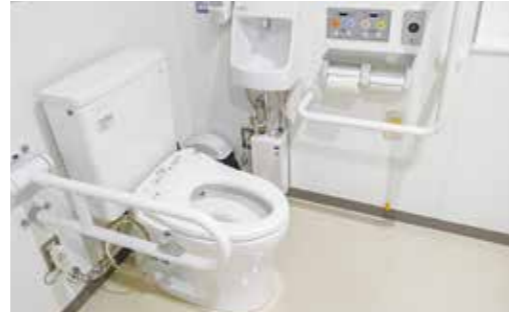
▲バリアフリー設備
