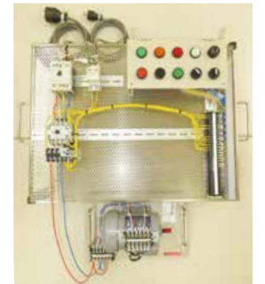
▲電動機の直入れ運転
