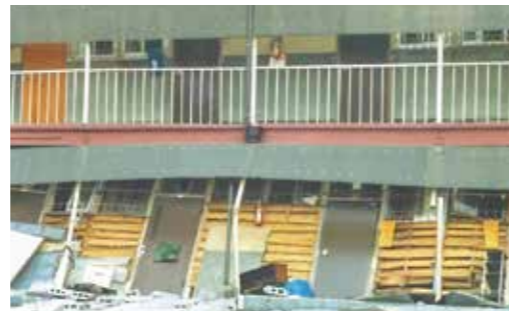
▲地震により倒壊した木造家屋の現地写真
