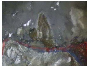
写真-4 漏水（側壁部）
