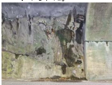
写真-3 うき・ひび割れ・剥離
