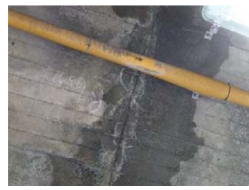
写真-5 漏水（天端部）
