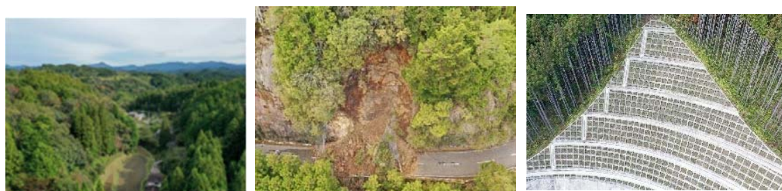
写真2. 砂防指定地の土地監視・被災状況確認・施設点検状況
