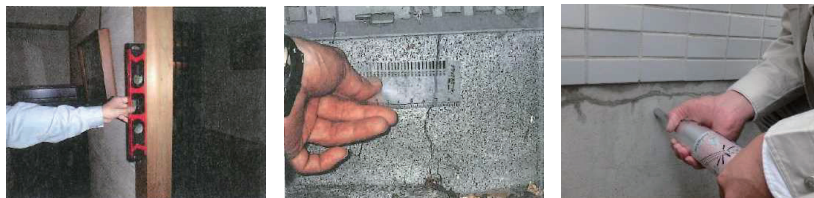
水平器による柱の傾きの計測 クラックスケールによる基礎のひび割れ幅の計測 コンクリートの圧縮強度の測定
