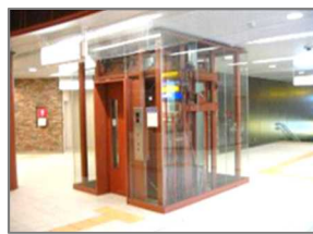
エレベーター
